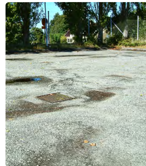
Det blir ofta sättningar runt rännstensbrunnar.
