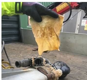
Figur 8. Våtserverter som sätter igen pumpar i pumpstationer
